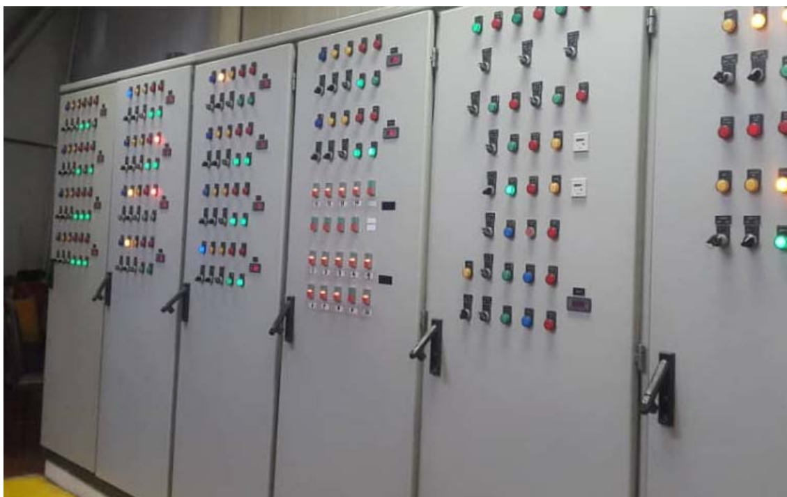
یک سیستم تعیین دمای محیط سردخانه
